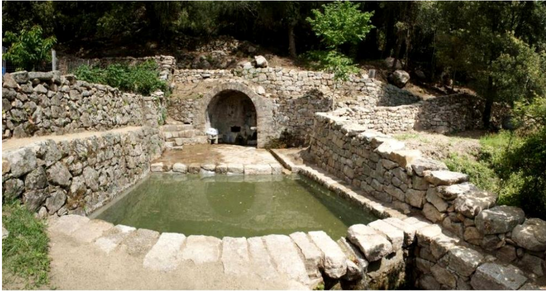
Photo 105. Réfection d'une fontaine-lavoir, Sentier de Vero Office de l'Environnement de la Corse, 2016
