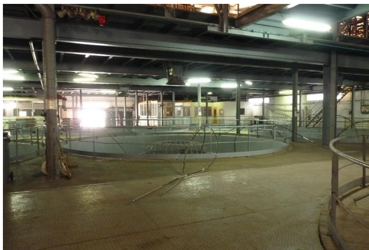
Stockage de réserve d'un câble sous-marin.
