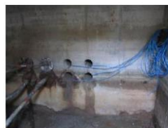
Figure 2 : Vue intérieure d'une chambre-plage (Orange Marine)
